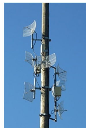
Exemple d'antennes Wi-Fi
